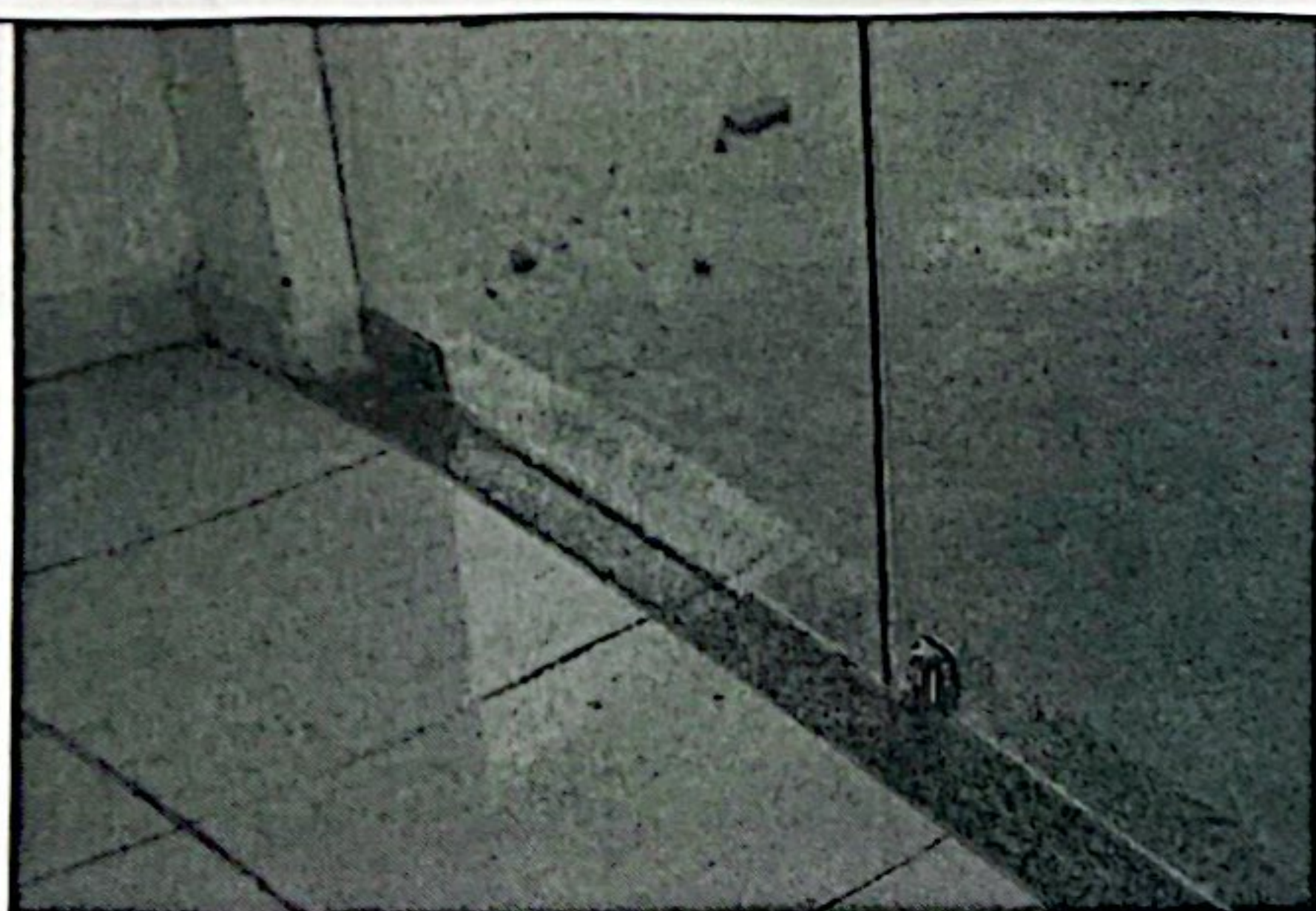
Foto 03: Problemas com a instalação da porta de vidro.
